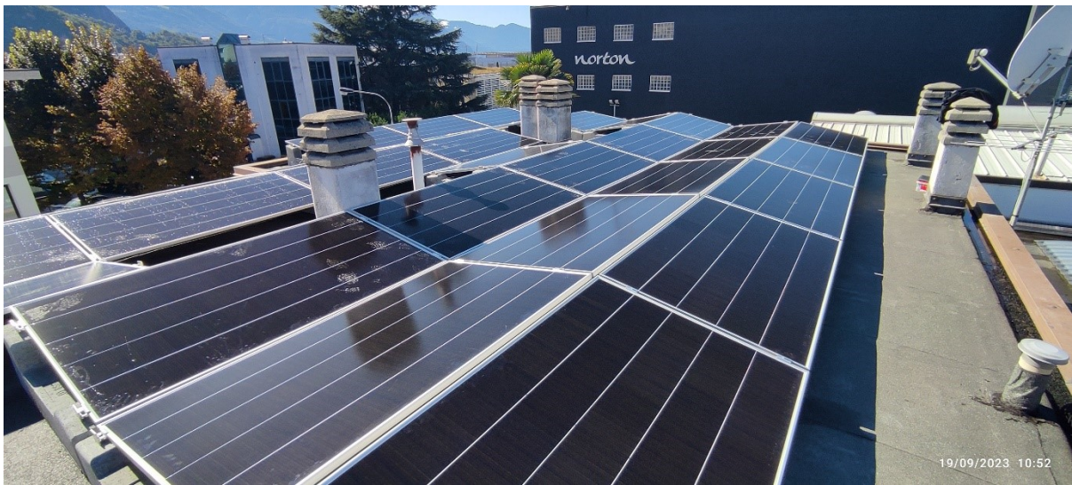
Foto: il nostro impianto fotovoltaico da 14,75 kWp installato sul tetto della ns. palazzina
