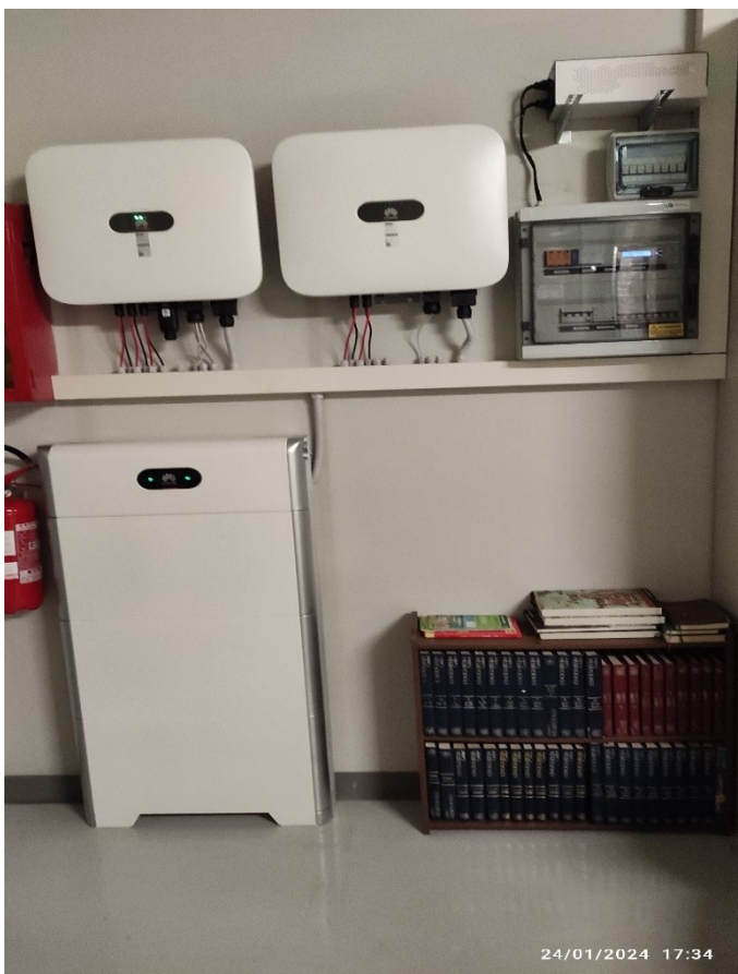
Quadro elettrico - Inverter e sistema di accumulo da 15 KW
